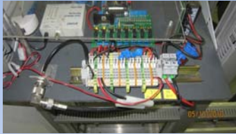
Relaissteuerung über HAMNET
